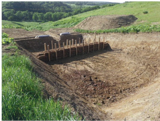
写真 6-14 天然ヤシ繊維フィルター付き仮設沈砂池
